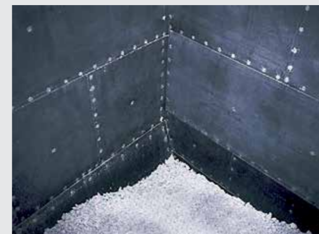
Depósito de farinha bruta com revestimento contra aderência KALEN 1006
