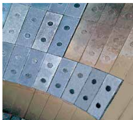
Entrada de moinho de carvão com KALCAST
