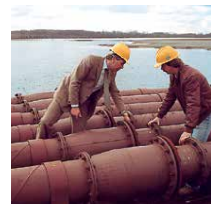
Tubos longos precisam de compensadores para equalização de comprimento
