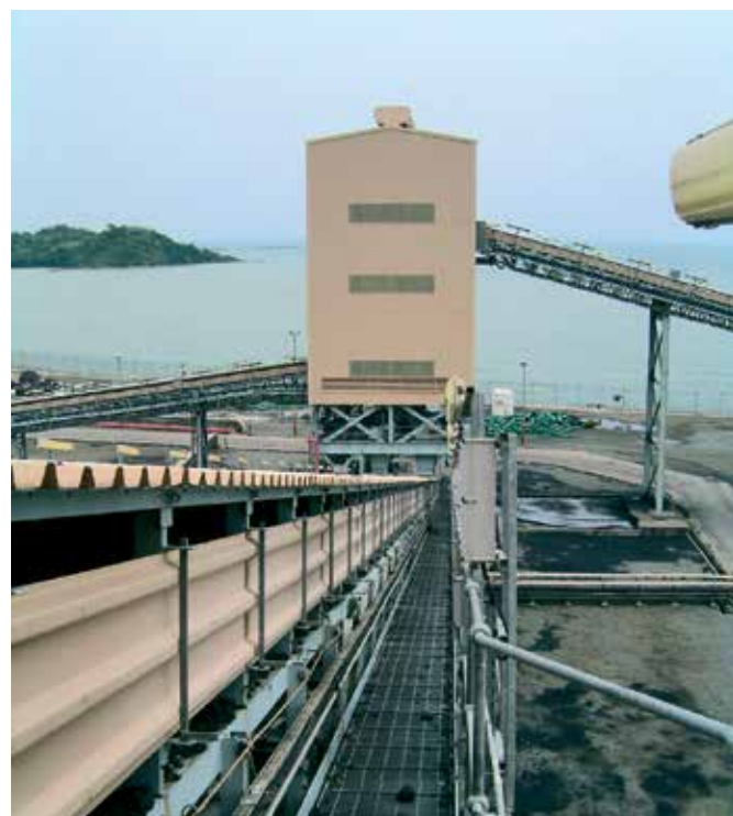
Os sistemas de transferência de carvão são protegidos com basalto fundido ABRESIST ou cerâmica de óxido KALOCER (exemplo nas Filipinas)
