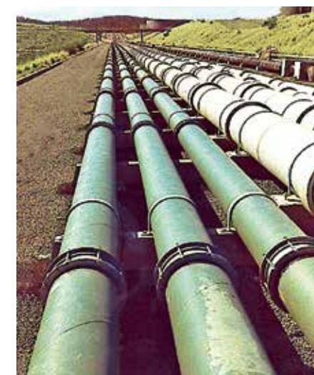
Tubulações hidráulicas e pneumáticas protegidas contra desgaste
