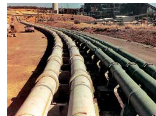
Tubulações na Austrália; os tubos são conectados com acoplamentos Victaulic
