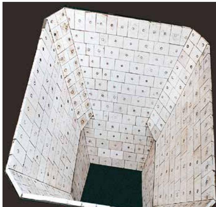
Tremonha do sistema de alimentação com placas KALOCER fixadas mecanicamente
